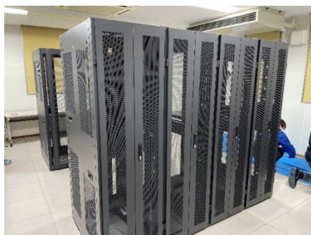
(左) 新しい計算機室のラック
