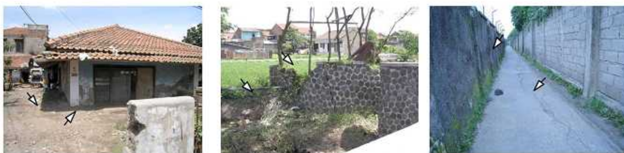
図2 . 現地調査で収集した現地写真：地盤沈下によってインフラが多数被害をうけた（矢印）
