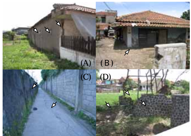
図 7.地盤沈下によるインフラの被害(一部)を示している
