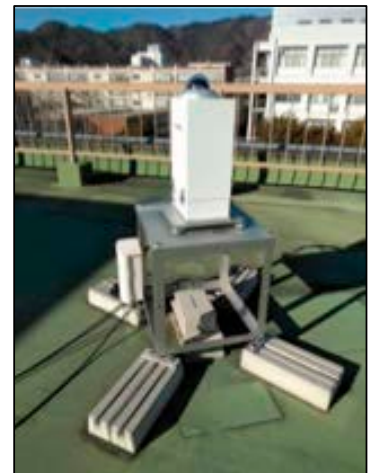
図2 野外観測対応の電源部防 水対策強化
