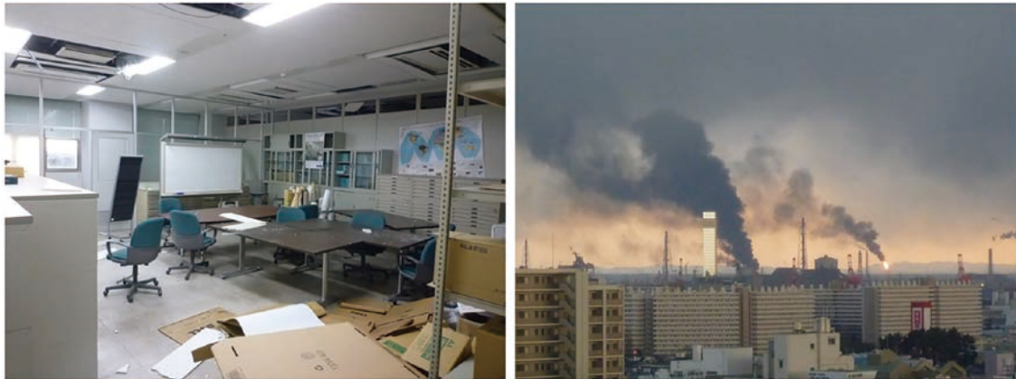
図1.4 総合研究棟8階の天井板の落下と臨海部コンビナートからの黒煙
